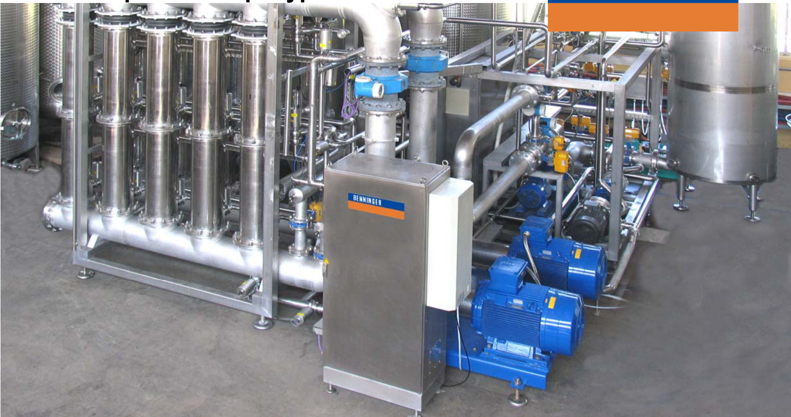
Установка ультраfiltrации на 20 м 3 /м
